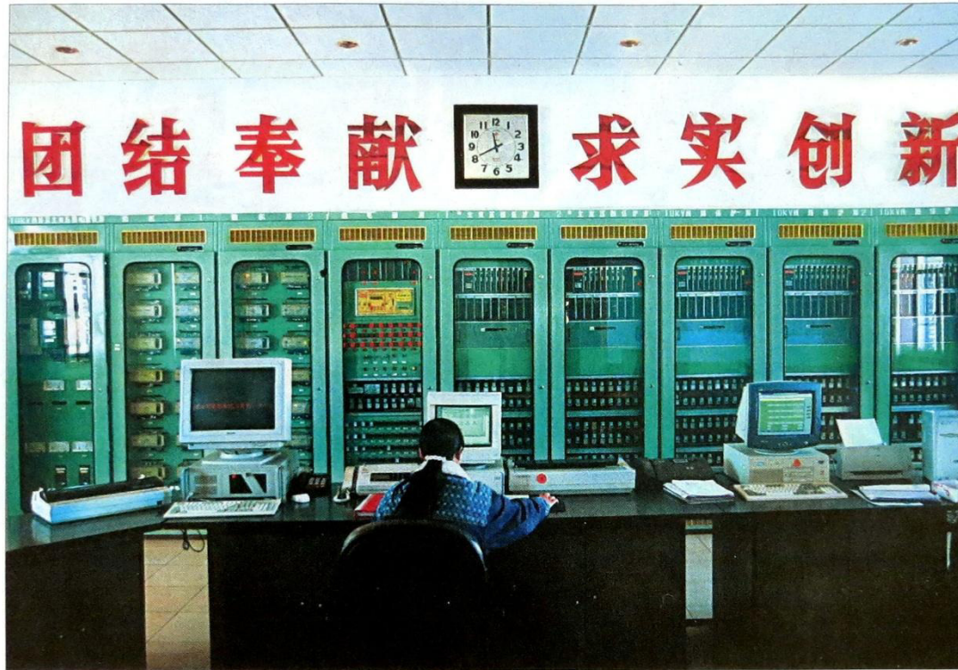
Im Steuerstand eines Windparks in der Inneren Mongolei regiert eine Frau. Über den Schaltschränken steht: Mit vereinten Kräften pragmatisch erneuern
